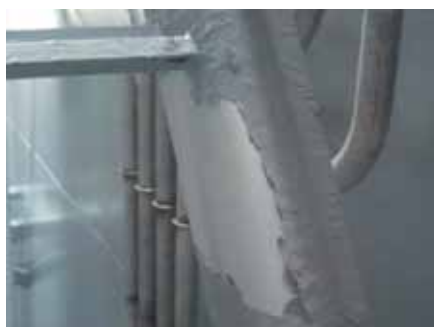
Coating dañado con motivo de la temperatura excesiva.
