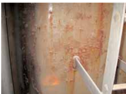
Deterioro del coating del tanque.
