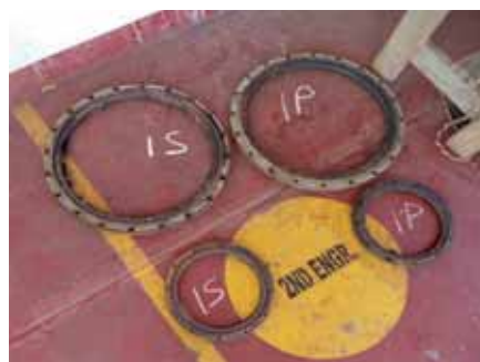
Aros dañados con motivo de la naturaleza corrosiva de la mercancía.
